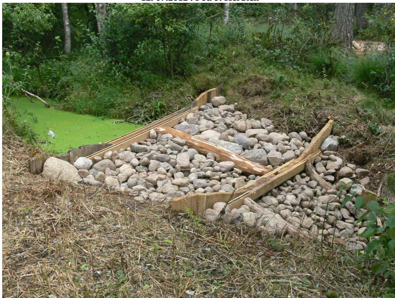
Rezerwat Łebskie Bagno. Rozbudowana i wzmocniona zastawka piętrząca wodę na rowie. 12. 07.2012 . Fot. J. Herbich
