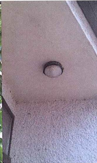
Oprawa Plafonowa szt.2 poz.4
