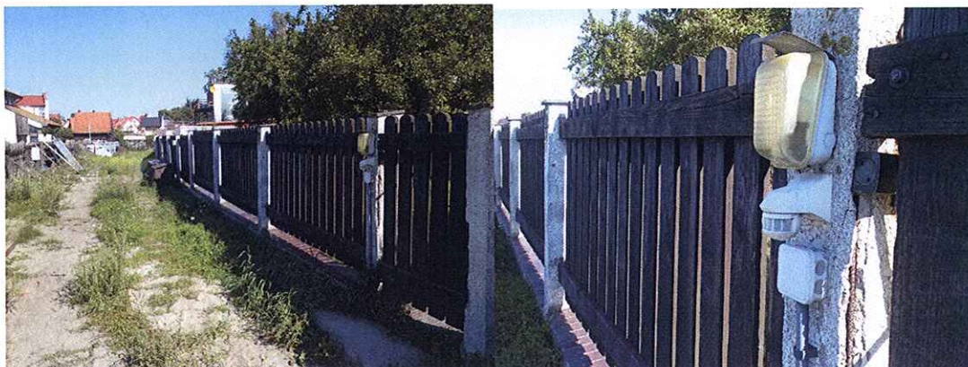
OPRAWY DO WYMIANY, OGRODZENIE PRZY TORACH – ZAPLECZE FOKARIUM (szt.5 poz.6)
