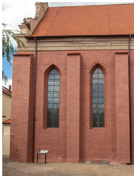
Kościół pw. św. Andrzeja Apostoła w Barczewie – elewacja południowa korpusu nawowego, stan przed konserwacją i po konserwacji.
